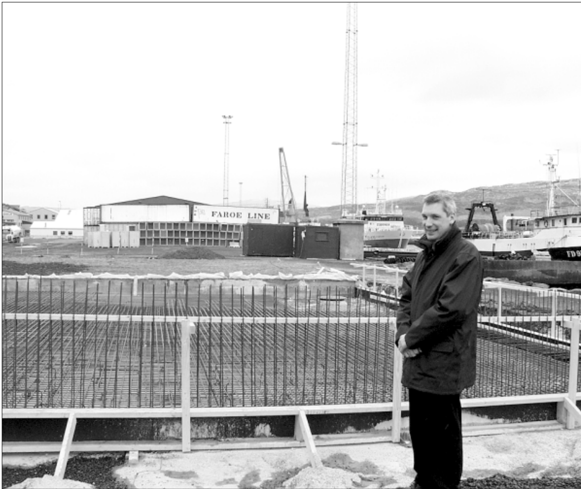
Rodmundur Nielsen, borgarstjóri í Runavík við fundamentið til goymslusiðloirnar, sum bygdar verða í samband við, at Runavík er vorðin útgerðahavn, nú farið verður at leita eftir olju undir Føroyum
